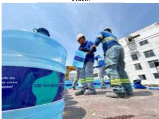
Figura 10 - Fornecimento de água potável disposto em balsa.
