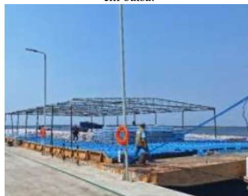
Figura 11 - Fornecimento de água potável disposto em balsa.
