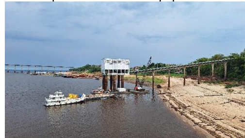
Figura 3 - Vista da captação da ETA II na Ponta do Ismael com suporte de balsa e guindaste para transporte de bombas e equipamentos.
