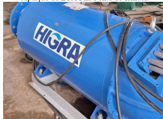
Figura 9 - Bomba HIGRA a ser instalada na captação da ETA I na Ponta do Ismael.
