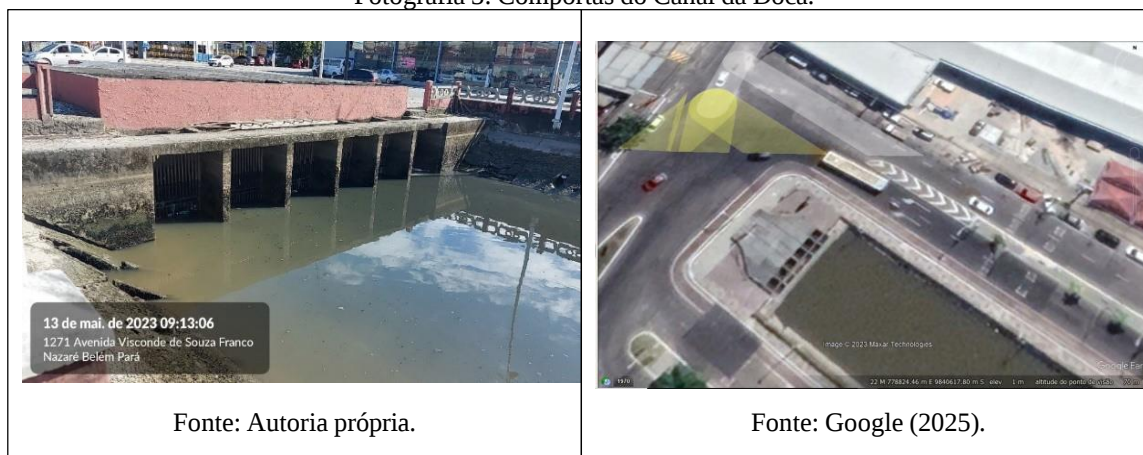
Fotografia 3. Comportas do Canal da Doca.
