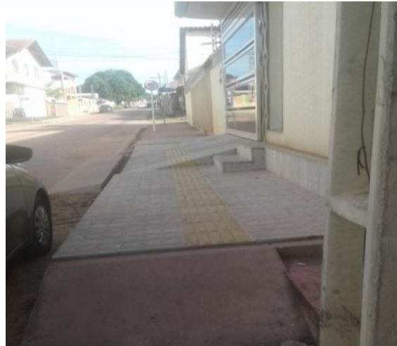
Figura 7: Irregularidade na construção de calçadas normatizadas.
