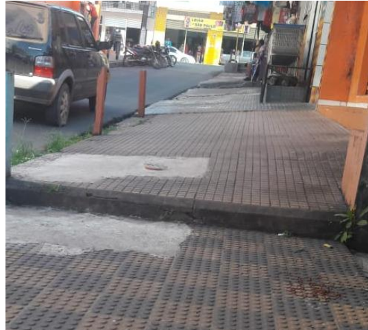
Figura 168: Calçada desnivelada, deteriorada e ocupada, Centro de Santarém.
