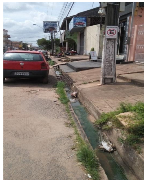
Figura 3: Calçadas desniveladas e ocupadas.
