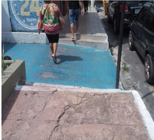
Figura 15: Deterioração de calçadas, Centro de Santarém.
